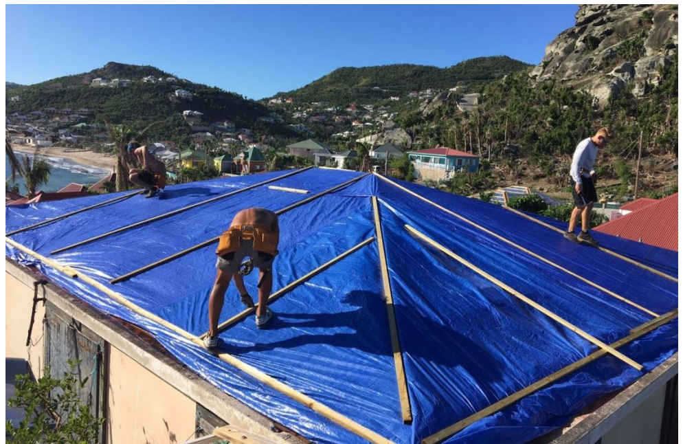
Bâchage bénévole d'une habitation par des couvreurs mobilisés par St-Barth Essentiel © St-Barth Essentiel
