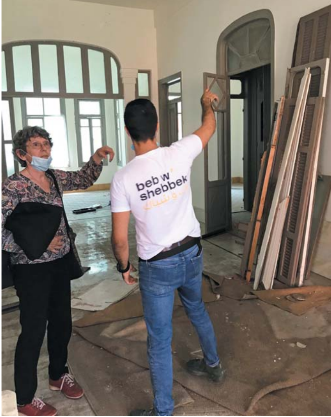
Visite d'un chantier de ULYP/Beb w'Shebbek par Elisabeth Longuenesse, présidente du comité Solidarité Liban de la Fondation de France.
